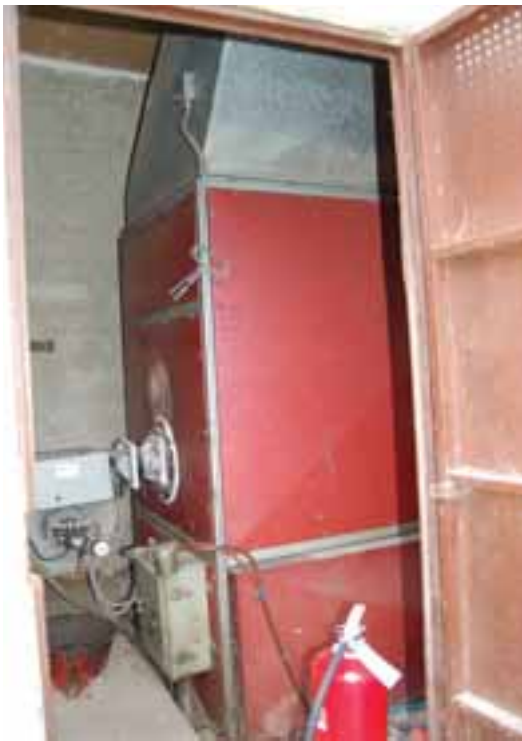
La nostra caldaia
